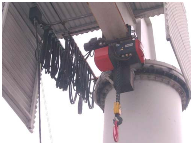
Die Laufkatze wurde erst vor ca. 2 Jahren erneuert.
